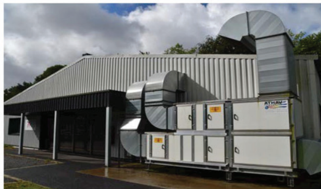
Le bâtiment dédié au laboratoire du centre de production de semence est lui aussi sous air filtré et en surpression
