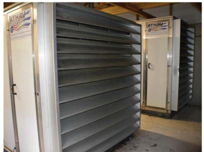
Les caissons de filtration de l'air entrant évitent toute entrée de pathogènes dans la verraterie.
